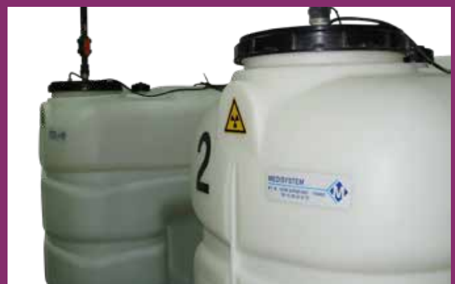
Cuves de décroissance
